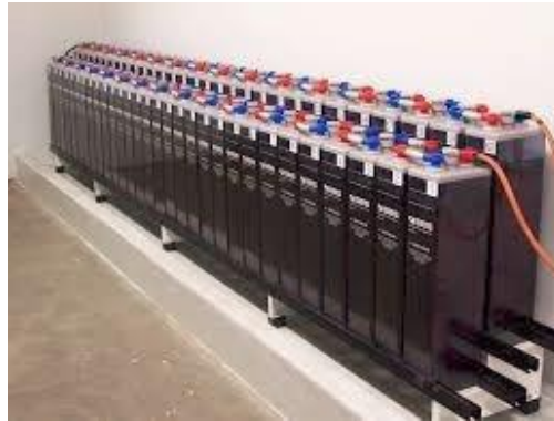
Figura 2 7 - Baterias estacionárias para sistema solar. Fonte: MEXCOM (2019).
